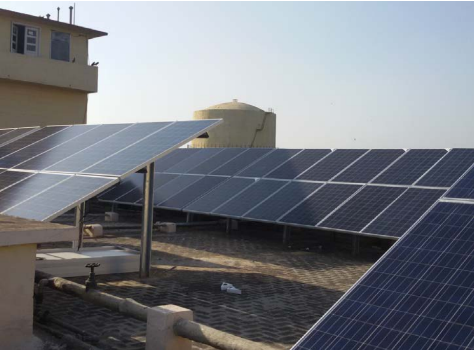
PV-Solaranlage auf dem Dach des Holy Family Hospital in Neu-Delhi
