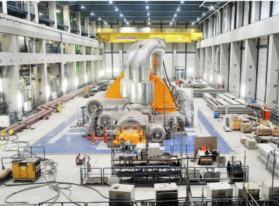
Rheinhafen-Dampfkraftwerk Karlsruhe, Maschinenraum Block 8
