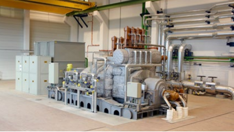
Industrieller Dampfturbosatz einer thermischen Rückstands-Verwertungsanlage
