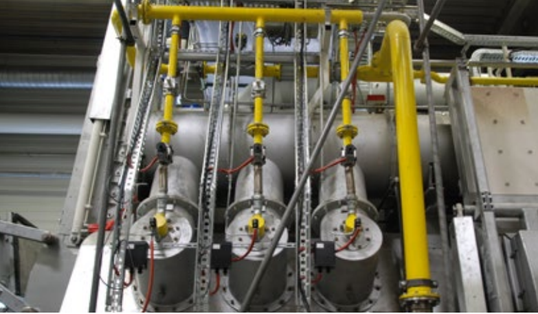
Regenerativfeuerung an einem Schmeldeofen Fabrik Jasper
