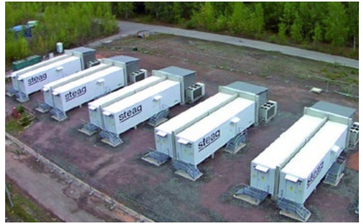
Batteriespeicher-Farm in preisgünstiger Containerbauweise
