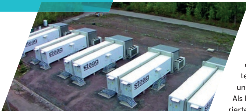
Batteriespeicher-Farm in preisgünstiger Containerbauweise
